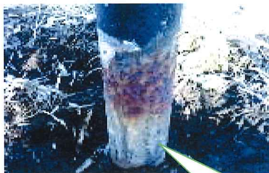
腐食した直管パイプ
